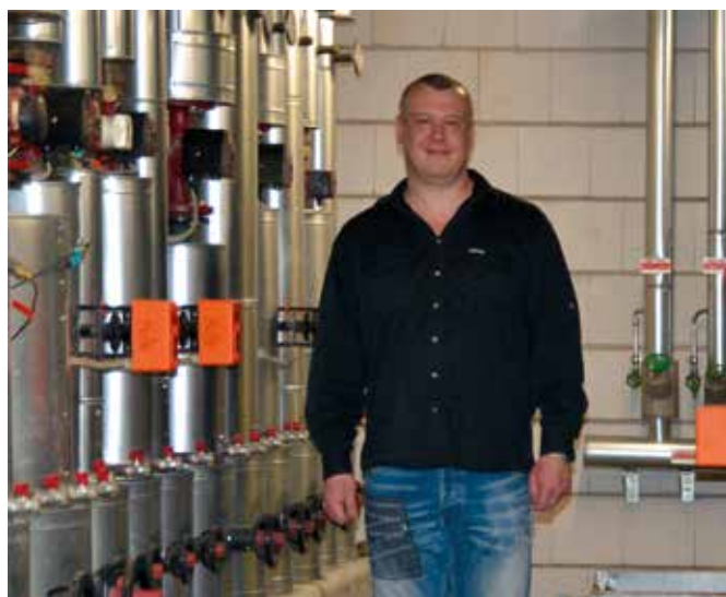
Hausmeister Oleksandr Yarinovsky bei der Inspektion der Versorgungsleitungen
